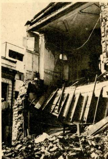
Daños causados por el violento sismo del 3 de marzo a un edificio de la ciudad de Santiago.
