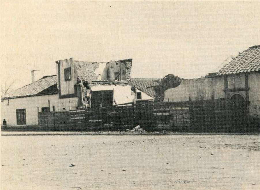
Estado en que se encuentra actualmente el monumento nacional, a consecuencia del derrumbe del frontis, causado por los temporales del invierno de 1982. Debe ser reparado.
