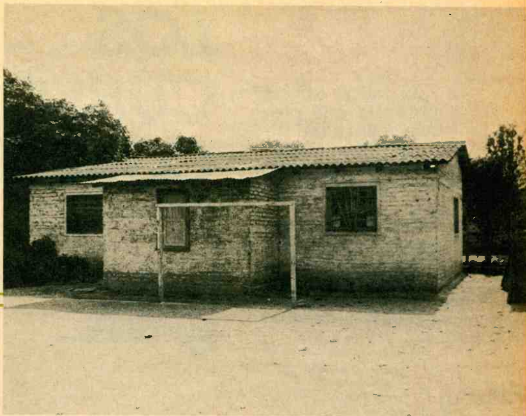
Escuela G N° 769 Tres Acequias que se encontraba en malas condiciones de edificación y salubridad.
